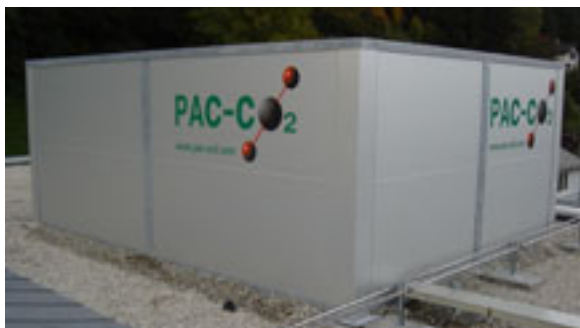
Figur 4: CO 2 -Wärmepumpe zur Trinkwasserbereitung auf dem Dach des Spitals von Le Locle.
