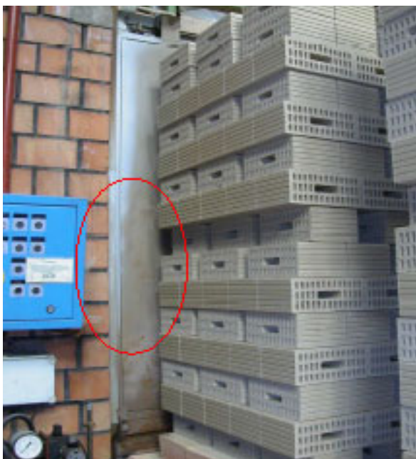
Figur 7: Eingang zum Tunnelofen.
