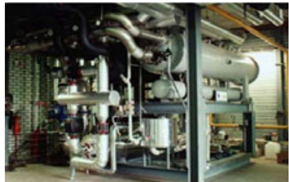
Figur 6: Absorptionskälteanlage (Quelle FH Burgdorf).
