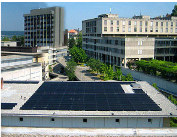
Figur 8: Teil der Flachdachanlage ETHZ (Bildquelle: Energiebüro).
