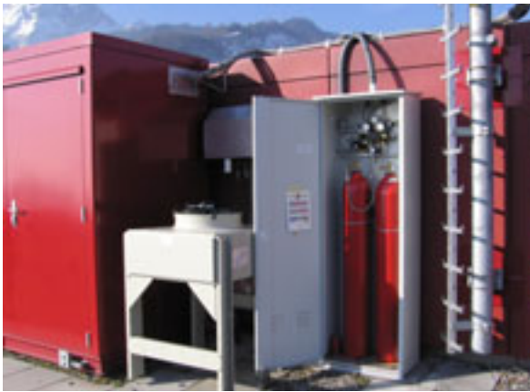
Figur 24: Aussen Ansicht der USV-Anlage für Mobilfunkantennen mit Luftkühler und H_2 -Druckflaschen direkt neben der Antenne [26].
