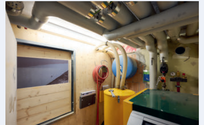
Le chauffage à pellets est très silencieux et son fonctionnement très efficace.
