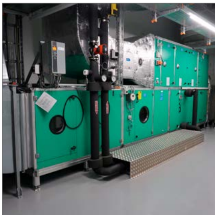
Moderna centrale di aerazione
