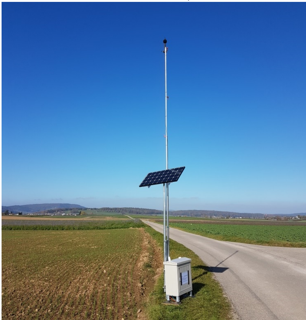
Illustration 2: Exemple de station de mesure se composant d'un microphone, d'un panneau solaire et d'une armoire de mesure (© Empa)
