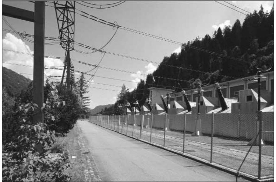
Le courant doit être transformé afin de passer d'un réseau de distribution à un autre.
