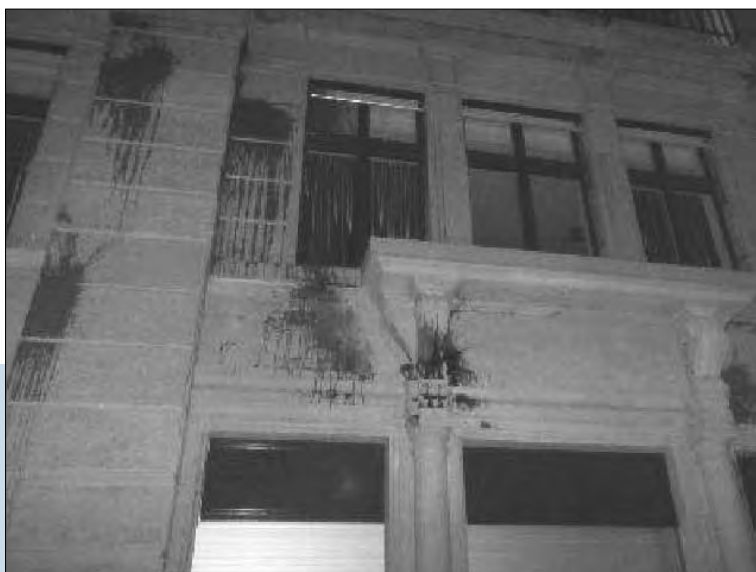
Sede del Credit Suisse di Zurigo imbrattata con vernice, 27 gennaio 2013
