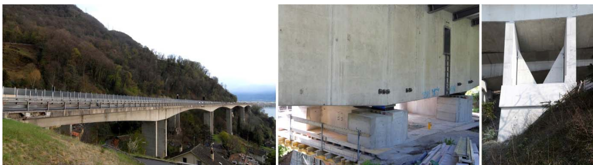
Abbildung 8: Erdbebenertüchtigung der Zwillingsviadukte von Chillon im Rahmen der Unterhaltsplanung (links), seismische Isolation mit Blei-Gummilagern auf einer niedrigen Doppelstütze (Mitte), Stahlbeton-Ummantelung einer höheren Doppelstütze (rechts). Bilder Thomas Wenk, Zürich.
