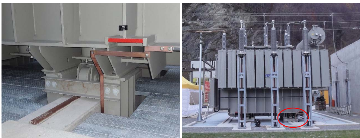
Abbildung 9: Verankerung eines Transformators gemäss Anforderungen der ESTI-Richtlinie zur Erdbebensicherheit der elektrischen Energieverteilung (axpo).
