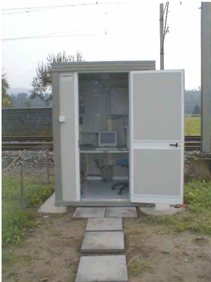
Container climatizzato con PC e elettronica di comando
