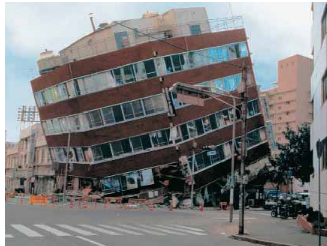
Gebäude mit unsymmetrischer Aussteifung (Kobe Japan 1995) [5]
