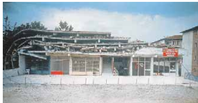
Gebäude mit «weichen» Obergeschossen (Ismit Türkei 1999, aus [5])
