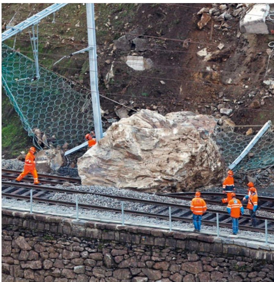
Le 14 novembre 2012, une chute de pierres a bloqué la ligne ferroviaire du Saint-Gothard à Gurtellen.
