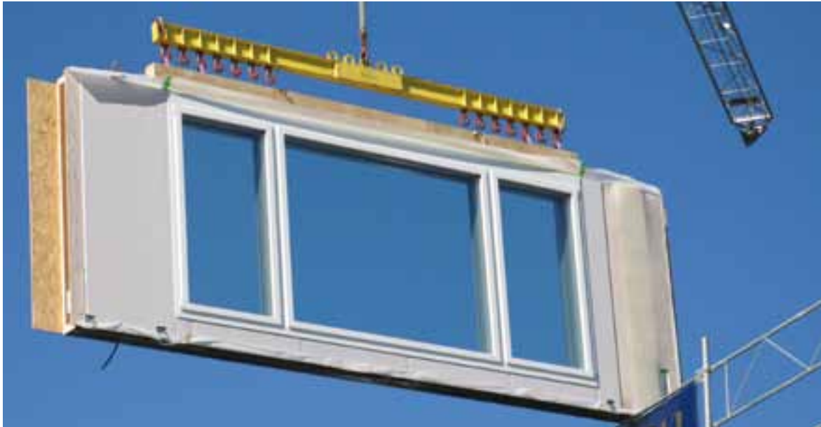
Rénovation d'un bâtiment locatif au moyen d'éléments préfabriqués. Le projet «Prefabricated Systems for Low Energy Renovation of Residential Buildings (ECBCS Annex 50)» de l'Agence internationale de l'énergie (AIE) développe, sous une direction suisse, des solutions novatrices permettant d'améliorer la performance de la rénovation des bâtiments locatifs. Les bâtiments sont mesurés en trois dimensions au moyen de scannage laser et de photographies aériennes. Les mesures relevées sont utilisées pour la préfabrication précise, en usine, des nouveaux éléments d'enveloppe. Les processus de construction sont ainsi fortement raccourcis. (Empa)
