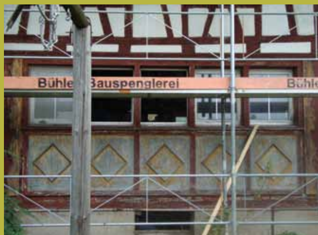
Détails nécessitant un assainissement durant les travaux de rénovation
