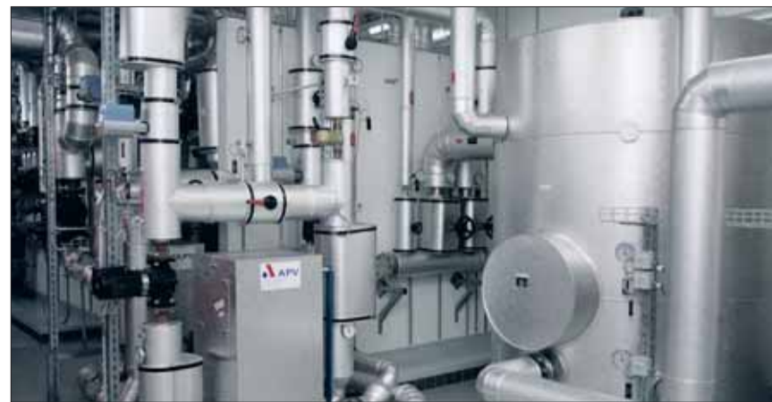
Grâce à l'optimisation énergétique d'exploitation, la Clinique psychiatrique universitaire de Zurich a augmenté son efficacité énergétique de 14% et économise chaque année 123 000 francs.
