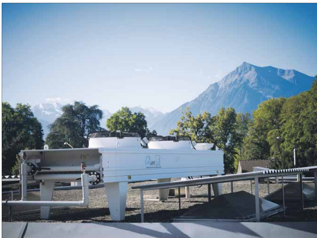
Le système de réfrigération de retour installé sur le toit transmet la chaleur résiduelle non utilisée au voisinage. Cependant, au-dessus de 15 degrés à l'extérieur, il rafraîchit aussi la salle des machines et les processus d'impression, et ce pratiquement gratuitement. (Photo: Regula Roost)
