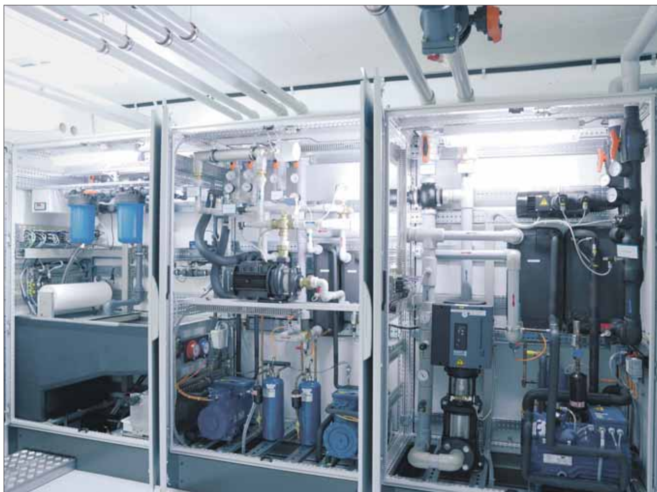
Les tâches qui incombent à l'installation EPMS sont la préparation de l'eau, la stabilisation en température des rouleaux de frottement et la production de froid pour la climatisation.
