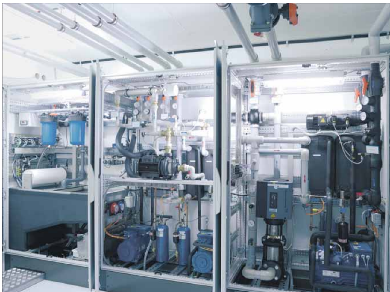
Die EPMS-Anlage ist für Wasseraufbereitung, Reibertemperierung und Kälteerzeugung für die Klimatisierung verantwortlich.
