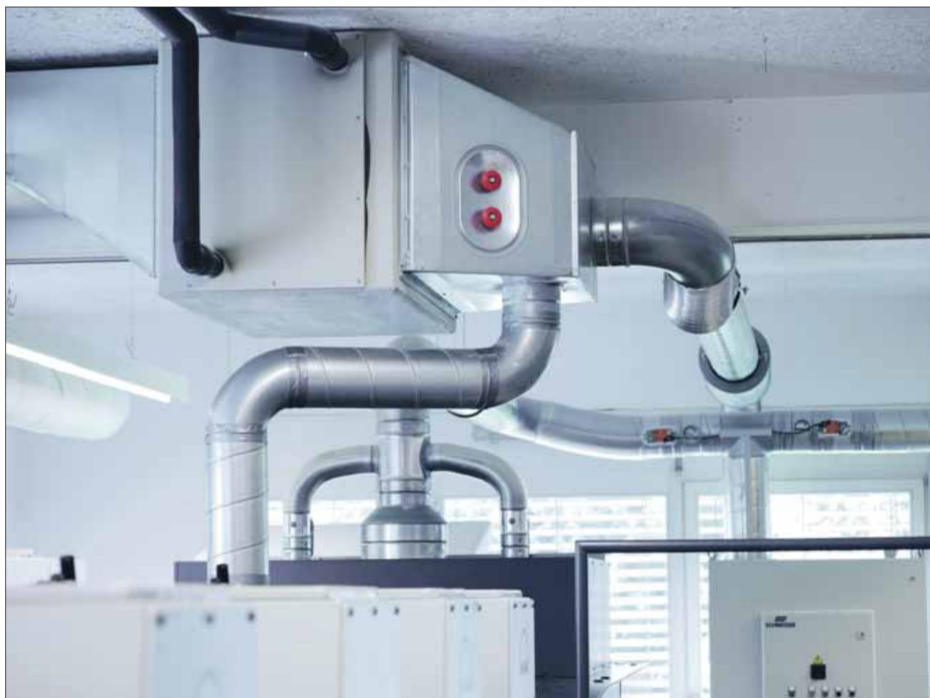
Der Wärmetauscher über der Auslage der R505LV entzieht der Abluft des Trocknungsprozesses und der Puderabsaugung der beiden Maschinen die Energie und stellt sie der Zuluft für den Monoblock zum Beheizen oder Kühlen des Drucksaals zur Verfügung. Und zwar so energieschonend wie möglich.
