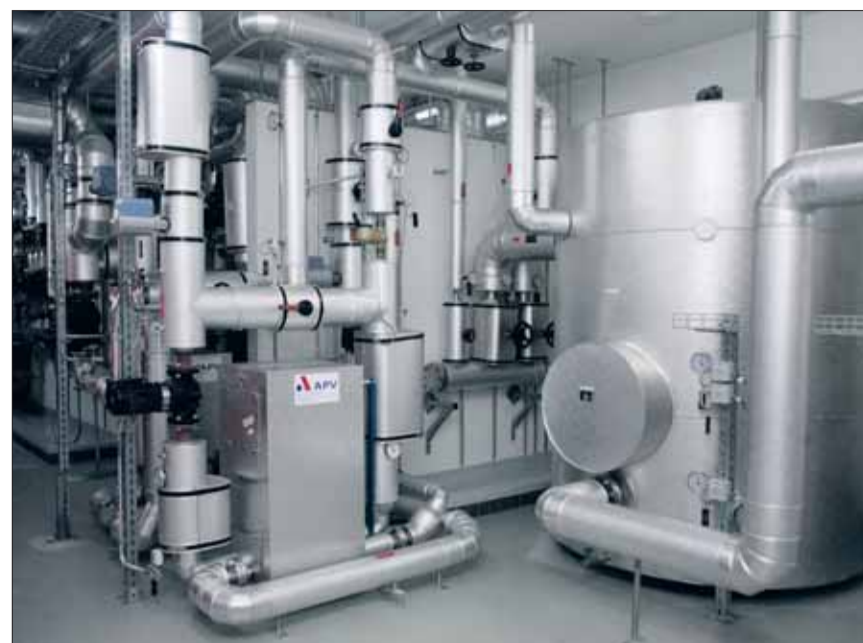
Durch die energetische Betriebsoptimierung erhöht die Psychiatrische Universitätsklinik Zürich ihre Energieeffizienz um 14 Prozent und spart jährlich 123 000 Franken.
