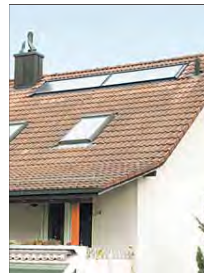
17h00: une seule journée a suffi pour monter l'installation solaire de l'eau chaude et son accumulateur.
