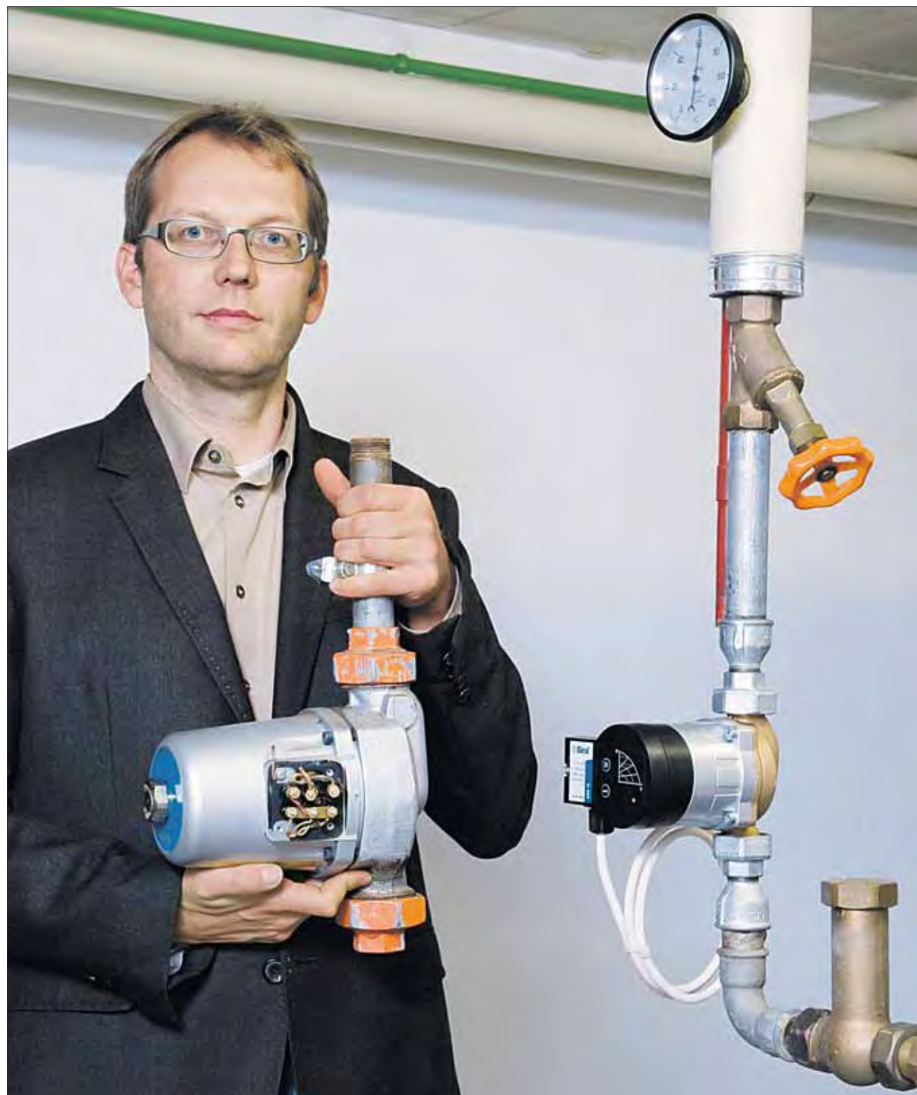
Energho-Ingenieur Daniel Zbinden vom Büro «Rückenwind» in Rüschlikon mit einer der Pumpen, die in der GEWOBAG-Siedlung in Zürich-Albisrieden ersetzt wurden. Die neue Pumpe (rechts im Bild) ist nun richtig dimensioniert. (Fotos: Christine Bärlocher)
