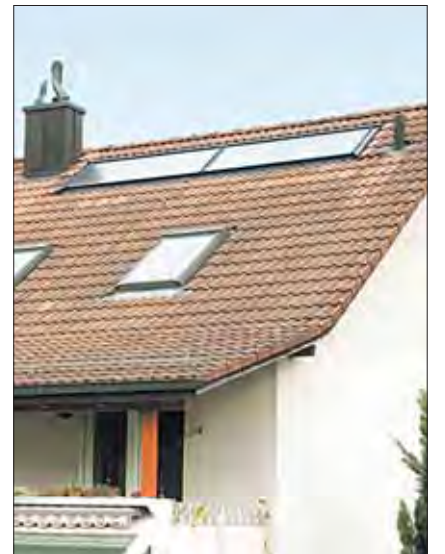
17h00: une seule journée a suffi pour monter l'installation solaire de l'eau chaude et son accumulateur.
