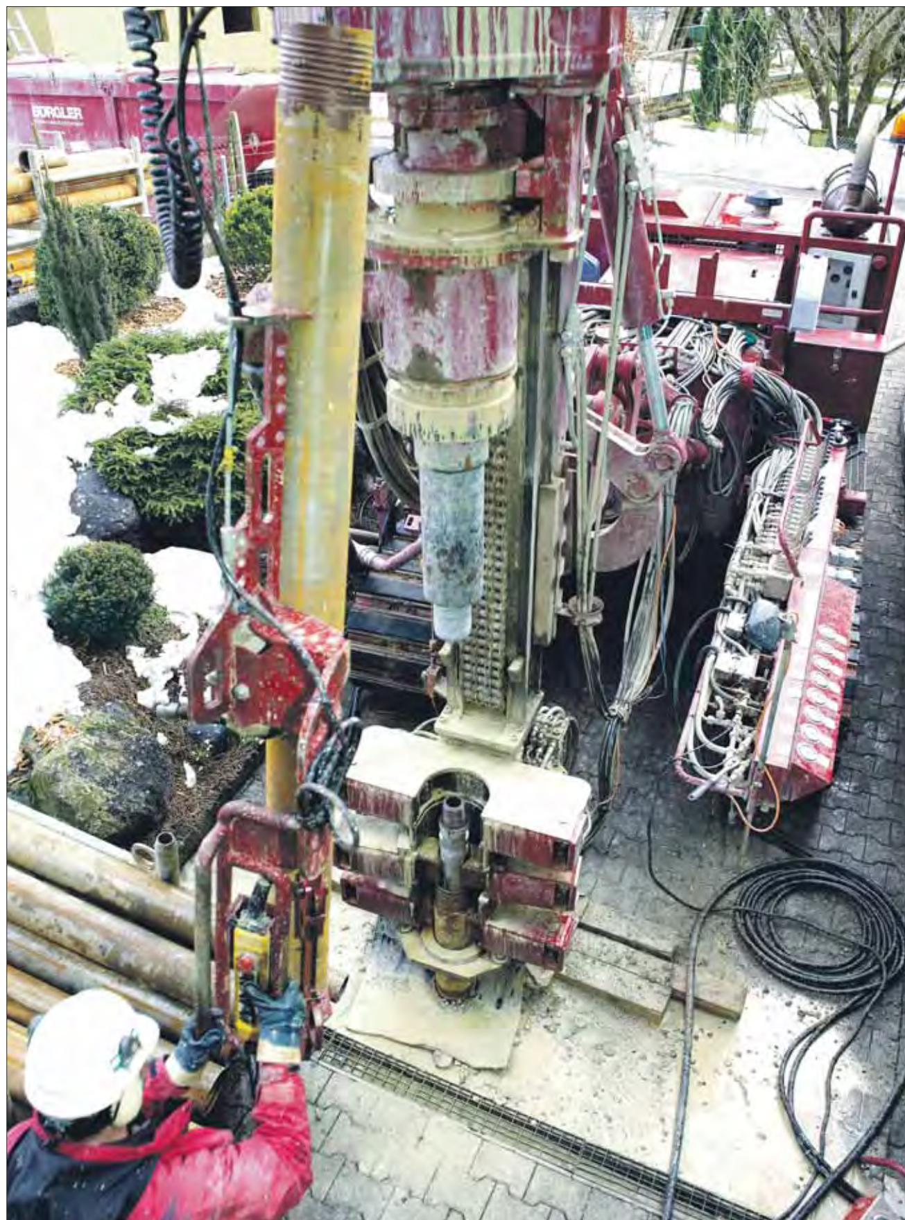
Au cours du creusement, la barre de forage et le tube chemisé doivent être rallongés au fur et à mesure. Dans les couches plus meubles en surface, un tube chemisé est nécessaire durant la phase de construction, afin que le trou de forage ne s'affaisse pas au moment du retrait de la barre de forage. Le creusement en roche dure ne met en œuvre que la barre de forage. Une fois la sonde géothermique enterrée, le trou de forage est comblé avec une masse genre béton – pour protéger la sonde et assurer une meilleure transmission de la chaleur.
