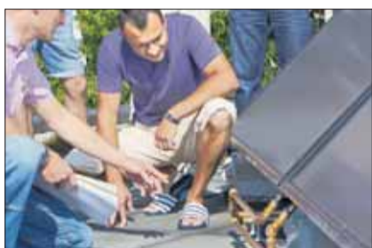
Formation continue: Suissetec mise sur l'efficacité énergétique et les énergies renouvelables. 17
