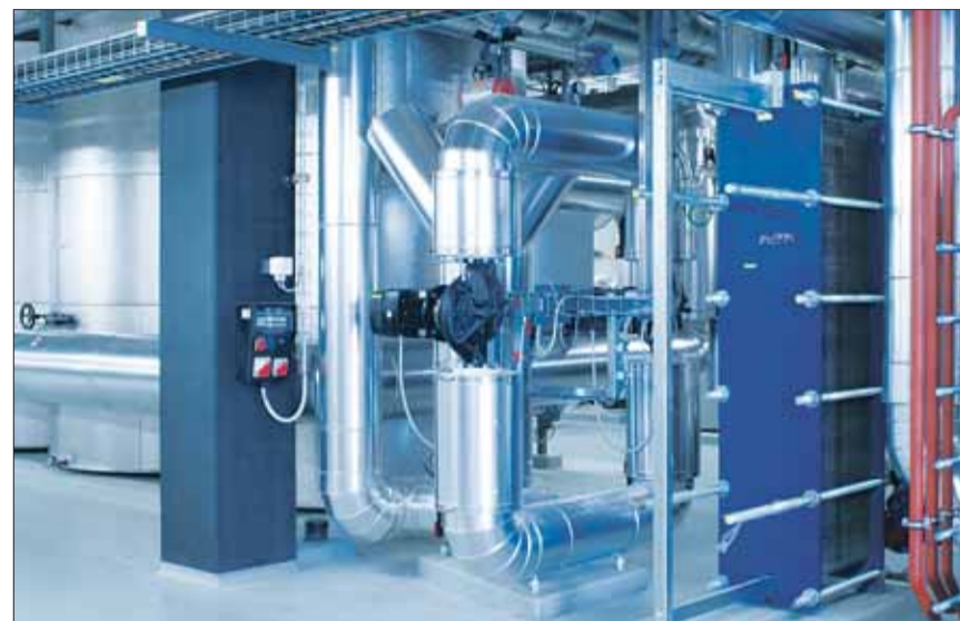
Wärmespeichertanks (links) mit Wärmetauschern (rechts) zur Rückgewinnung der Abwärme der Druckluftkompressoren (Fotos: Regula Roost)
