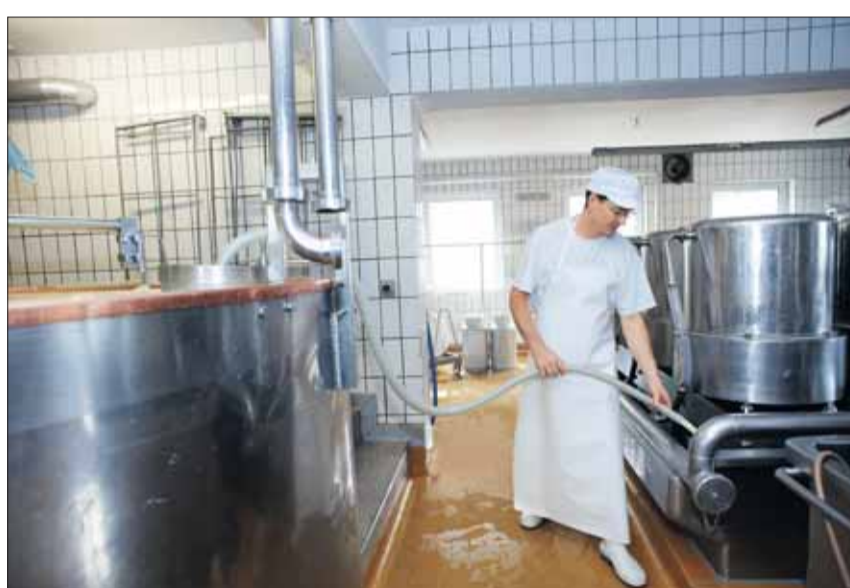
Mit Hilfe dieser Erfindung wird während des Erwärms auf 55°C zirka 25 Prozent der Schotte abgesaugt und dadurch viel Heizenergie gespart.
